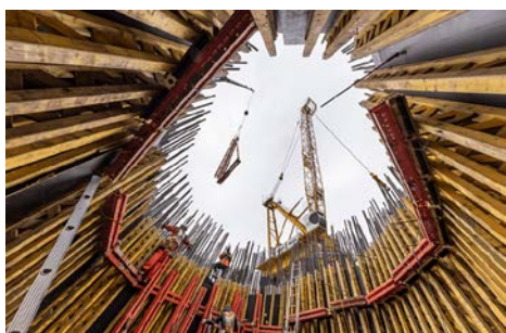
Zdjęcie 8 Deskowanie dźwigarowe VARIO GT 24 stanowiło idealną podstawę dla każdej sekcji konstrukcyjnej pylonu. W razie potrzeby można go połączyć z innymi systemami deskowań PERI. (Zdjęcie: PERI SE)
