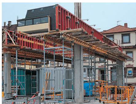
Przy pomocy wieży ST 100 ciężkie podciągi można betonować z wyprzedzeniem. Roboty przebiegają sprawnie, ponieważ wieża ST 100 często nie wymaga stosowania stężeń.
