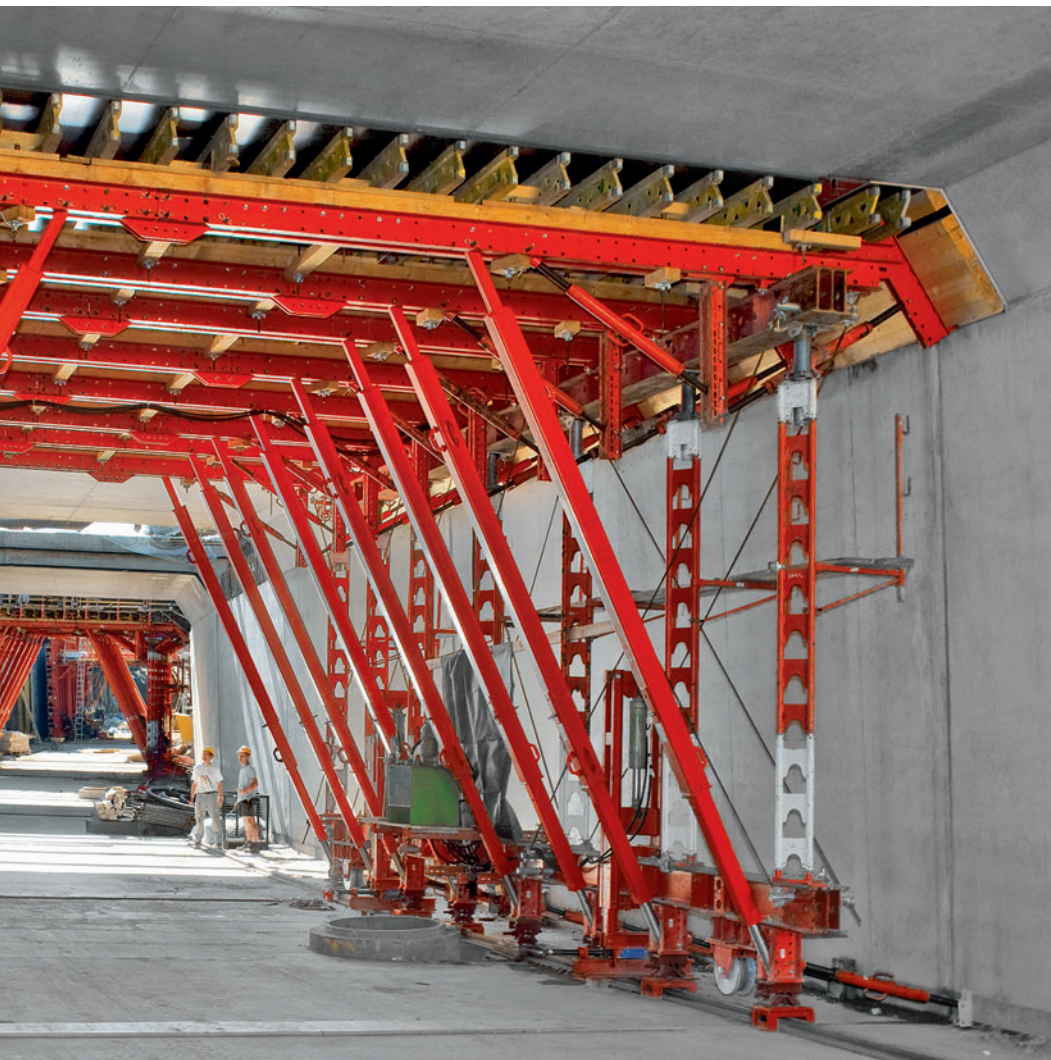
Podpory wysokońskie HD 200 wbudowane w urządzeniu przejeźdnym do wykonywania stropu przejmują obciążenia z realizacji tego tunelu wykonywanego w metodzie odkrywkowej.
