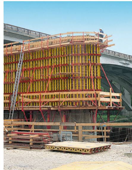
Filar nad brzegiem rzeki, zadesko- wany VARIO GT 24 ustawionym na pomo- stach roboczych KGF 240. Dopasowanie stron czołowych do form ostroluków od- było się przy pomocy standardowych, nadstawianych płyt VARIO.
