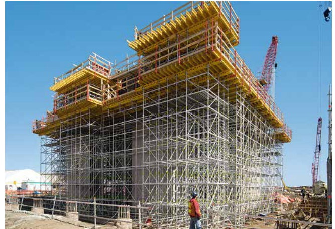
Systemy MULTIFLEX i PERI UP Rosett niezawodnie przenosiły na podłoże wysokie obciążenia od masywnych elementów konstrukcyjnych z wysokości od 10 m do 12 m.
