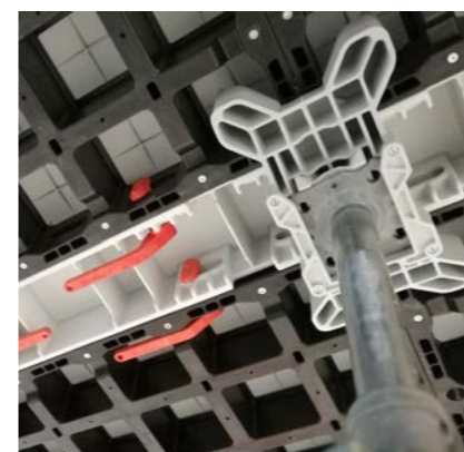
Metoda podparcia wtórnego z użyciem płyt o szer. 15 cm umożliwia wczesne rozdeskowanie, dzięki czemu płyty i łączniki będą gotowe do dalszych zadań.
