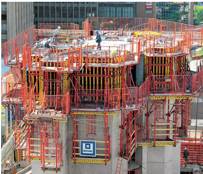
Budynek wysoki w Paryżu deskowany w VARIO GT 24 na pomostach roboczych CB 240.
