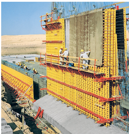
U góry: ściany oczyszczalni ścieków o zmiennym przekroju podłużnym zadeskowane VARIO GT 24.
